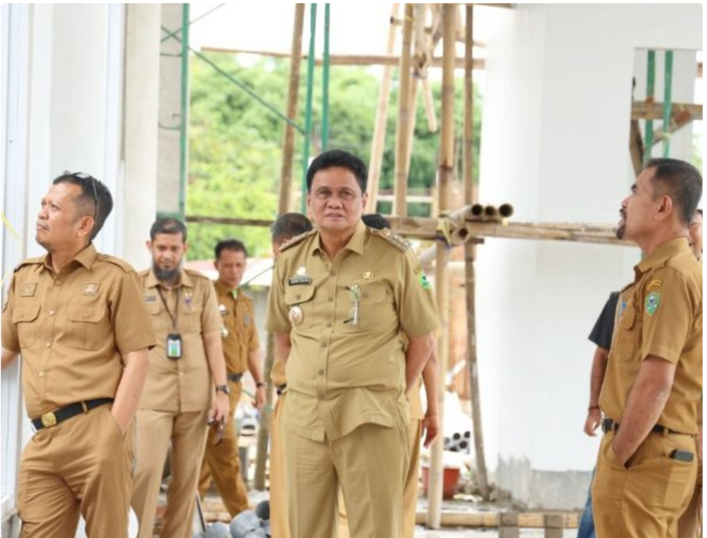
Bupati Barru, Ir. H. Suardi Saleh, M.Si, melakukan peninjauan langsung terhadap progres pembangunan Masjid Raya Barru
